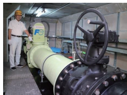
江ヶ崎発電所の水車
