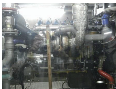
ガスエンジン (ガス化ユニットで発生したガスを使ってエンジンを動かし、電気と熱を発生させる)
