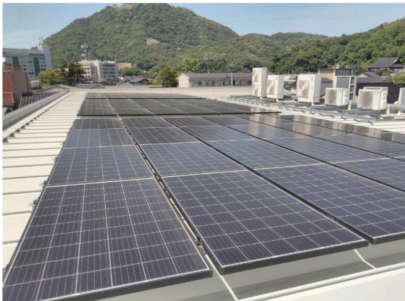
鳥取市のシンボル、久松山をのぞむ発電所
