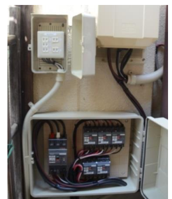
「自立電源モード」を備えた屋外パワーコンディショナー。今後10kW以上のFITでは、災害時に地域への開放が必要（リビルディングセンタージャパンにて撮影）
