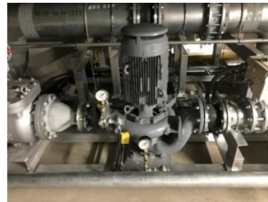
新田清掃 センター 小水力発電所
