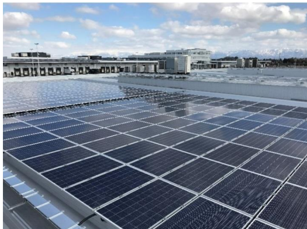
中央卸売 市場発電所
