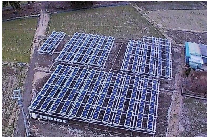
発電所全景（小田原かなごてファーム Web サイトより）
