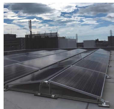
町田市民電力太陽光発電所1号機
